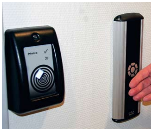
Universell utforming: Berøringsfri døråpning gjør hverdagen enklere for funksjonshemmede.
